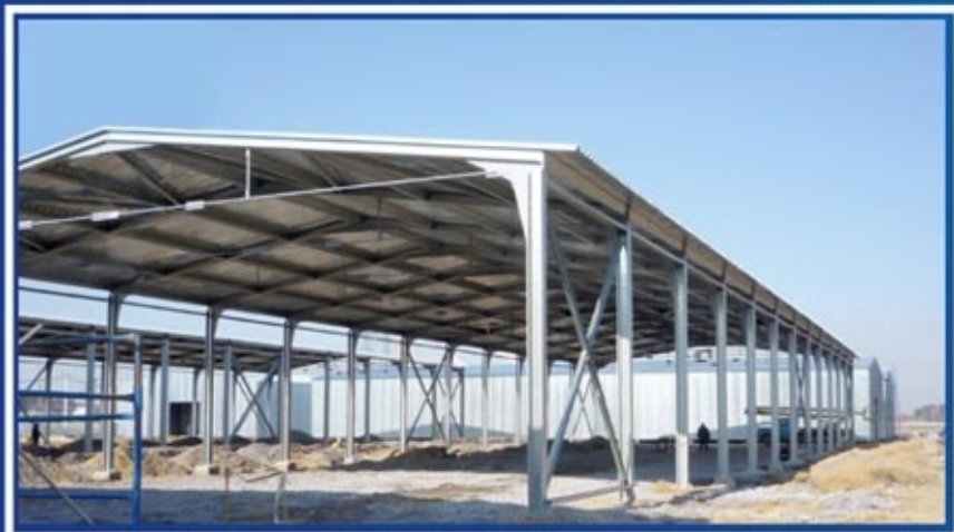
Рамное здание 9x27x4,7(н)м Станция автоконтроля (г.Грязи)
